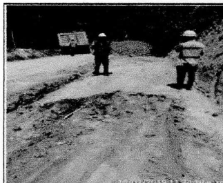
RETIRO FALLO LADO IZQUIERDO PR2,0-1,2-1,5
