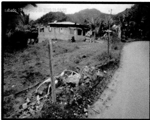
PR 3+200 Escombros pendientes de recoger
