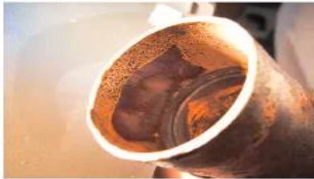
Metal de aportación no penetrado por completo
