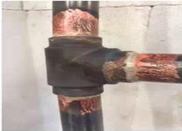
Junta de cobre a latón (sin limpiar)
