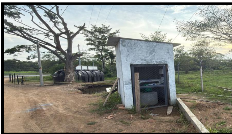
Imagen 3 y 4 – Tanque y cuarto técnico.
