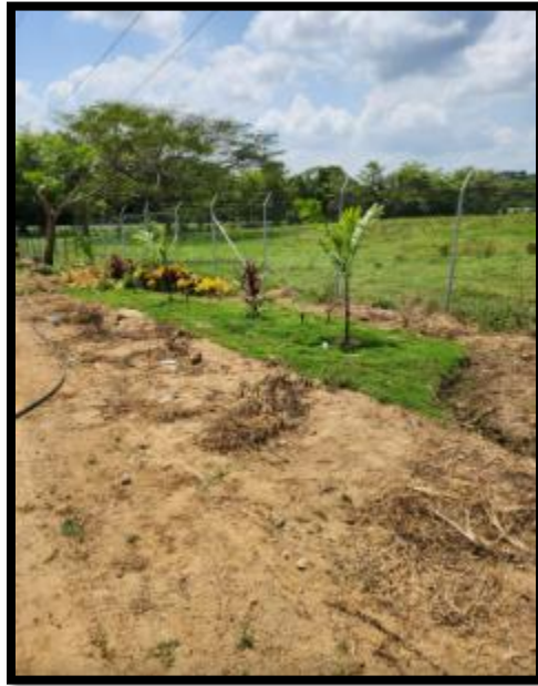
Imagen 9– Cuneta perimetral jardines (obstrucción por vegetación y residuos)
