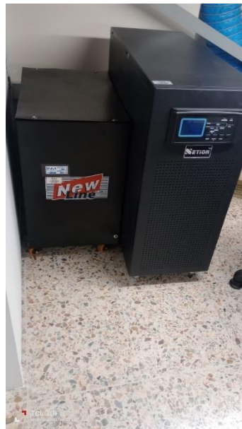
Figura 18, UPS desconectada y retirada de la ruta de alimentación del panel de control, dispuesta temporalmente en un costado del laboratorio.
