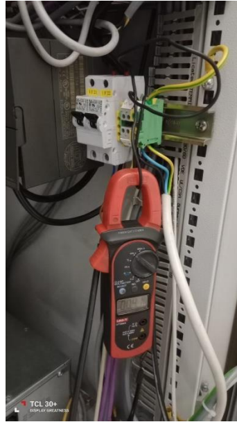
Figura 17, Verificación final de funcionamiento del panel de control, con consumo aproximado de 470 mA a 220 VAC después de las correcciones realizadas.
