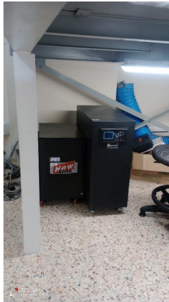
Figura 11, UPS retirada de la ruta de alimentación del panel de control durante la intervención.
