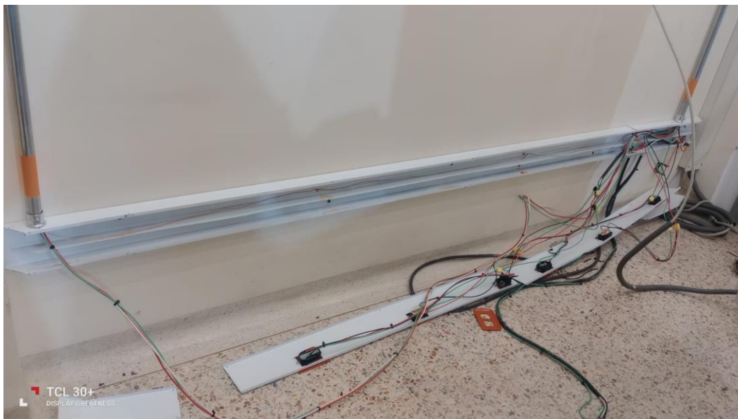
Figura 12, Revisión de la instalación eléctrica asociada al punto de conexión de la UPS durante la intervención.
