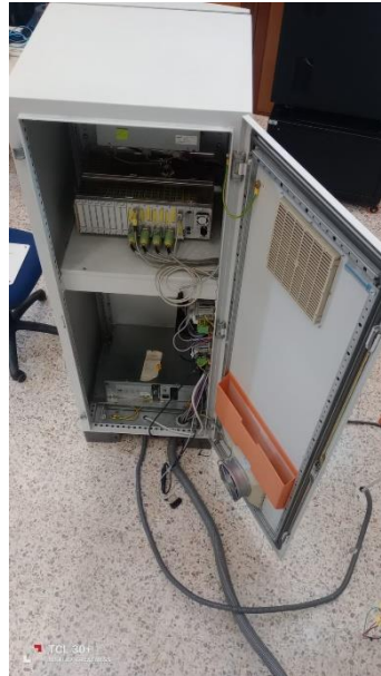
Figura 15, Panel de control abierto durante la ejecución de actividades de mantenimiento.
