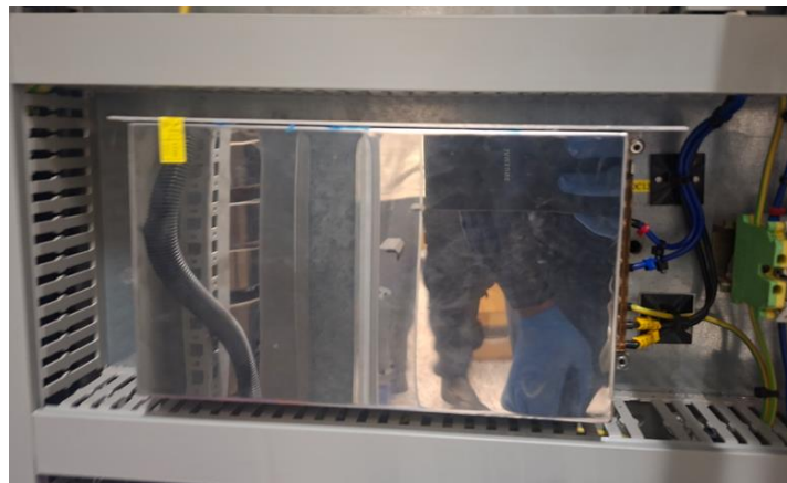
Figura 5e: Fuente de alimentación desconocida
