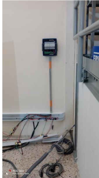
Figura 13, Revisión del subsistema de protección eléctrica asociado a la UPS que presentaba la falla.
