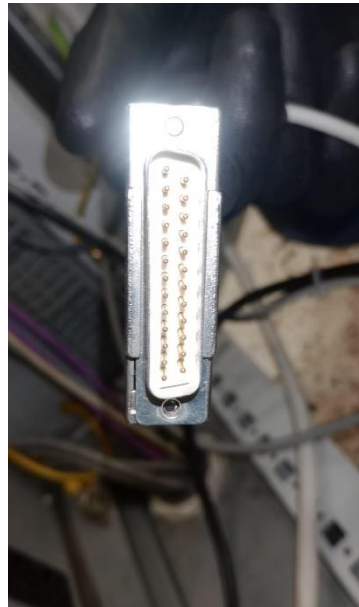
Figura 10, Conector DB25 proveniente de la antigua UPS, encontrado suelto dentro del panel de control y con pines expuestos.
