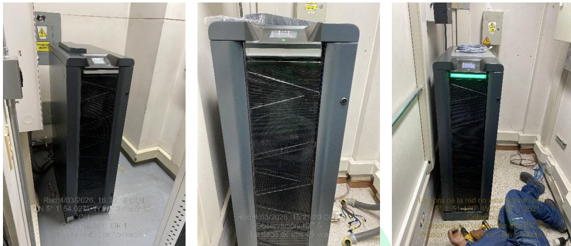
IMAGEN 6 UPS 20KVA – TRIFÁSICA
