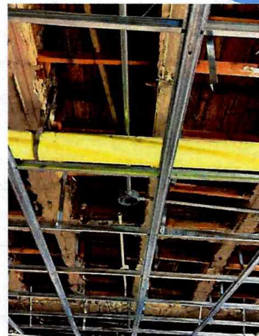
Salidas eléctricas tomacorrientes e iluminación
