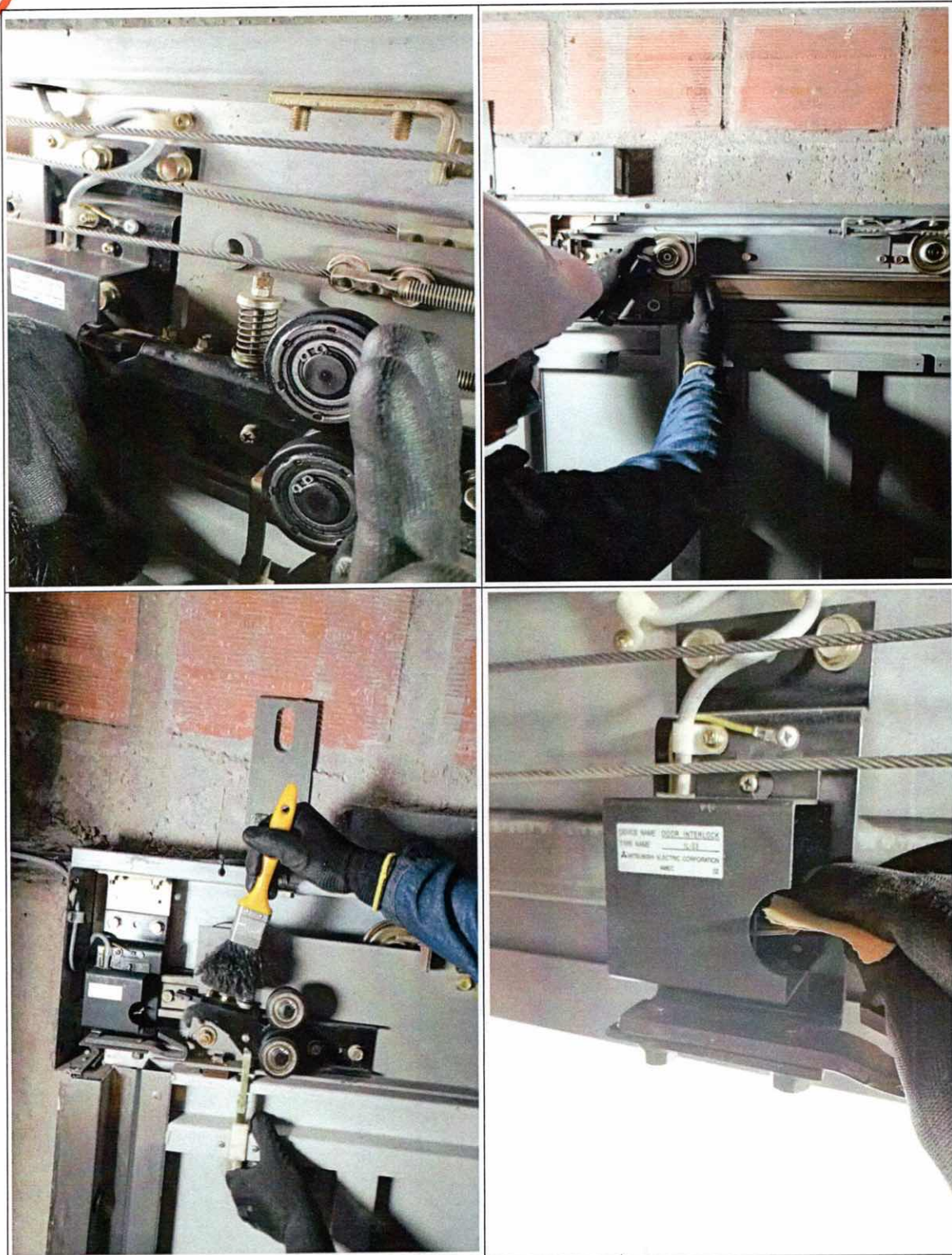
Ilustración 21: Revisión a cada uno de los mecanismos sobre cabina (inductores de aproximación, sistema de pesa carga, finales, prefinales limites superiores e inferiores). Mantenimiento preventivo a cada uno de los micros de seguridad.
