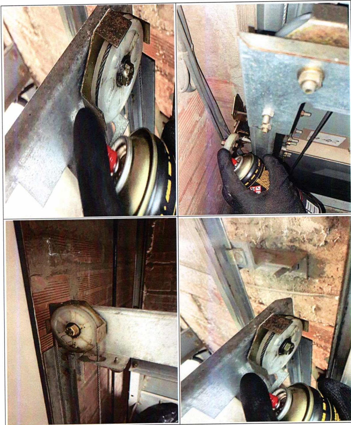
Ilustración 7: Mantenimiento preventivo, limpieza y lubricación a cada uno de los mecanismos de puertas de hall que conforman (correderas, excéntricas, guayas, topes, mantenimiento de rieles y micros de apertura) verificación a cada uno de los circuitos de aproximación de cierre de puertas.
