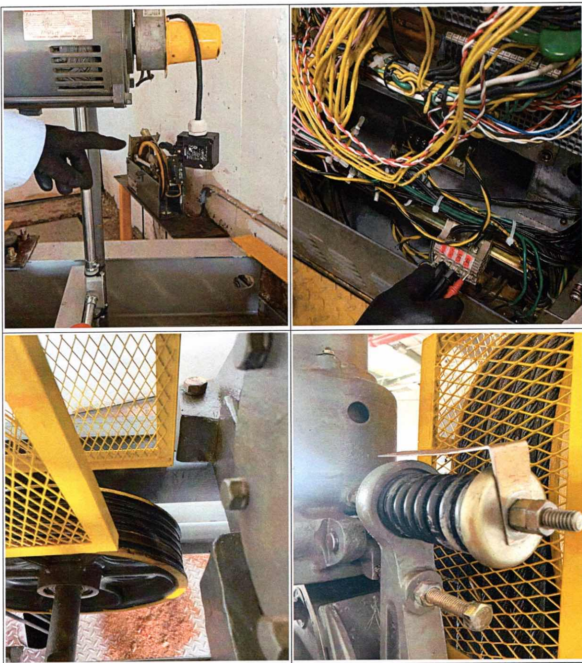
Ilustración 20: Revisión a cada uno de los componentes generales en cuarto de máquinas (motor, polea deflectora, verificación eléctrica al cuadro de control principal, verificación del estado de los cables de tracción, verificación al limitador de velocidad (gobernador)) ajuste y calibración al sistema de electro freno, verificación del nivel de aceite.
