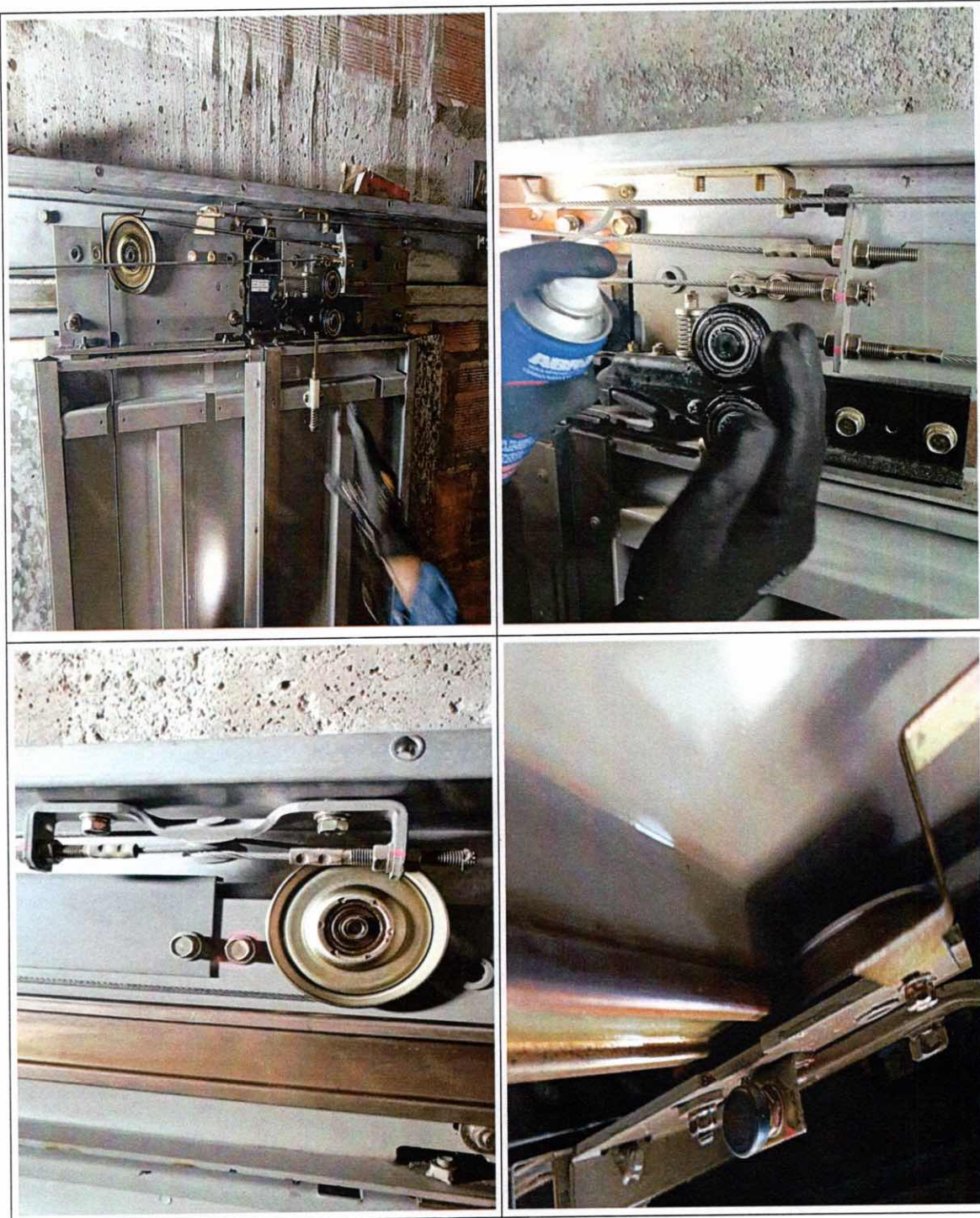
Ilustración 12: Mantenimiento preventivo limpieza y lubricación a cada uno de los mecanismos de apertura en puertas hall que conforman (correderas, zapatas, excéntricas, guías, contactos, resortes y guaya), verificación, cambio y ajuste de kit de zapatas para alinear y centrar las puertas hall, limpieza de quicios en cada piso.
