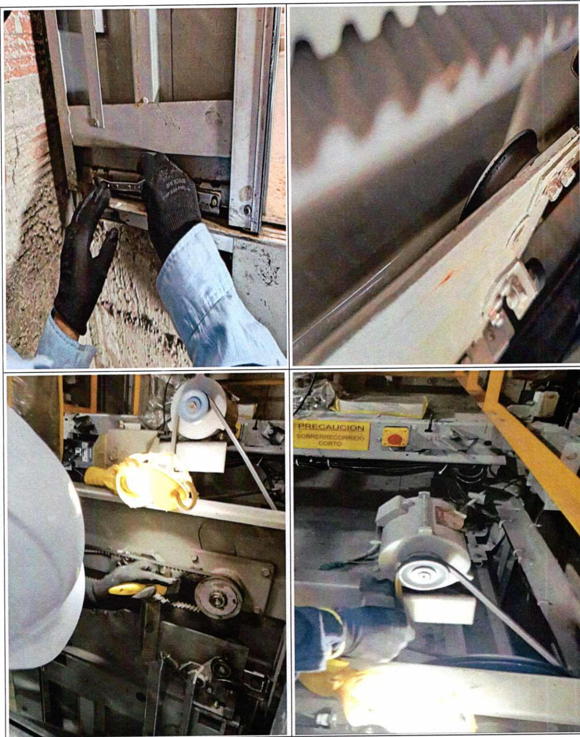
Ilustración 13: Mantenimiento preventivo, limpieza y lubricación a cada uno de los mecanismos de apertura y cierre en puertas de cabina, limpieza y lubricación a los ventiladores de cabina, verificación y ajuste a las hojas, a la correa de tracción y alineación de las bandas de rayos múltiples RX (emisor y receptor).
