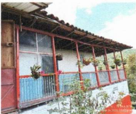
Imagen 8. Antes, Vivienda sin estructura de captación de agua
