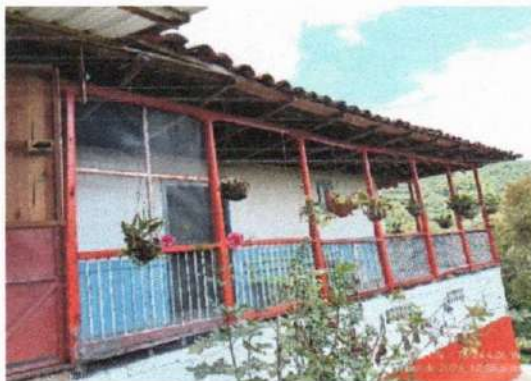
Imagen 15. Antes, Vivienda sin estructura de captación de agua
