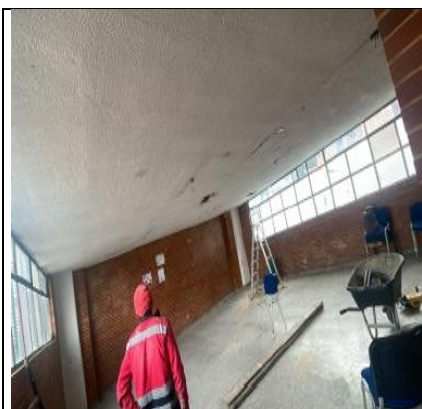
Salón 201 Estado inicial, se observa torta inferior en concreto placa aligerada
