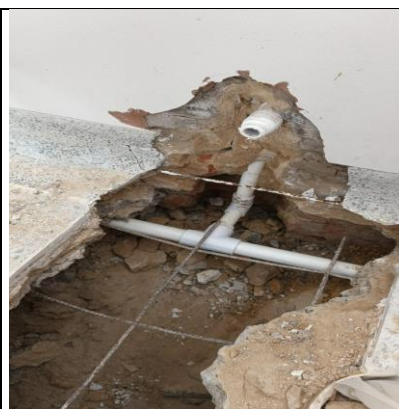
Baño hombres del segundo piso en sanitario con presencia de humedades.
