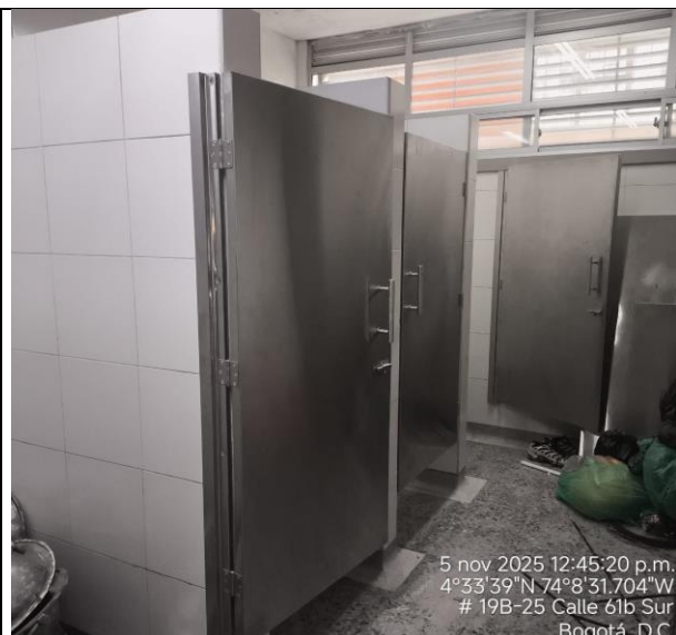
Baño Mujeres. Se observa estado inicial de los baños ubicados en el primer piso costado oriental.
