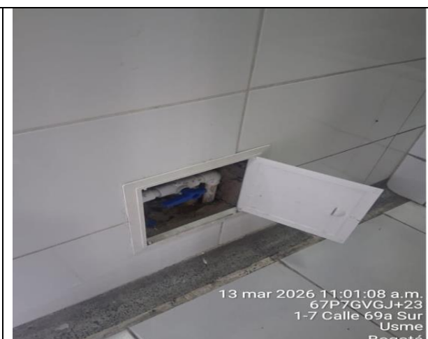
Visita técnica de obra para establecer presupuesto – Colegio Nuevo San Andrés de los Altos IED. Fuga registro agua potable.
