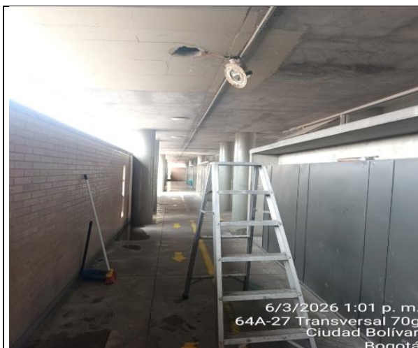
Pasillo frente a salones 210 al 218. Detección de humedad en techo, placa aligerada.
