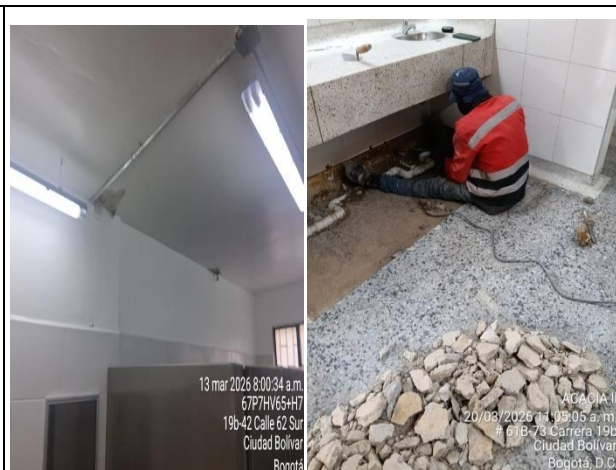
Baño mujeres segundo piso costado oriental. En sector debajo del mesón se presenta humedad hacia techo del primer piso de baño de mujeres. Se observa desprendimiento de pintura en techo.
