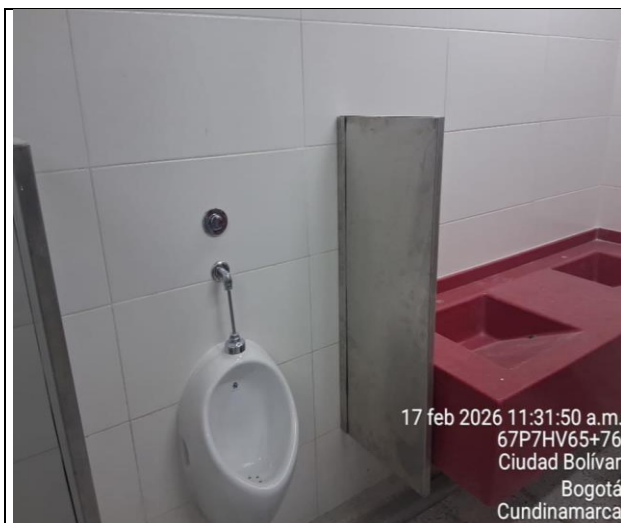
Baño Hombre. División orinal en acero inoxidable, instalación de orinal.
