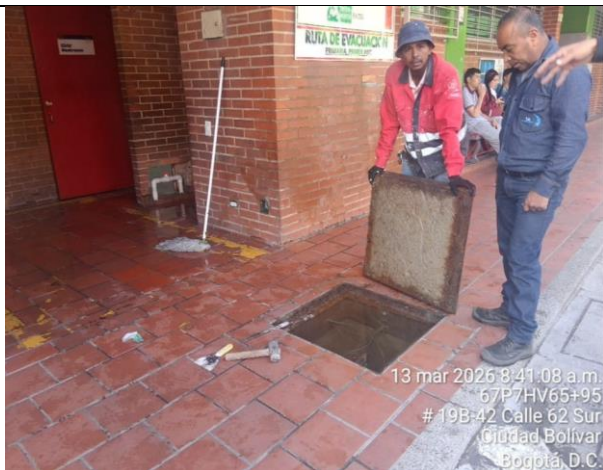
Almacén. Se observa filtración de agua potable en registro baños costado occidental. Caja de inspección llena de agua.
