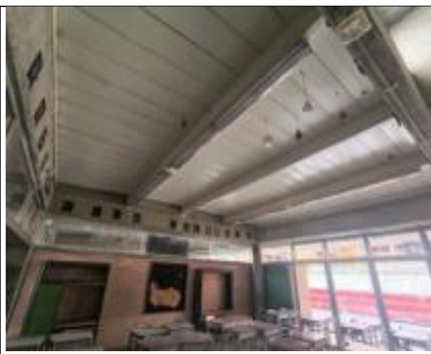
Cubierta. Filtración de agua hacia interior de aulas.
