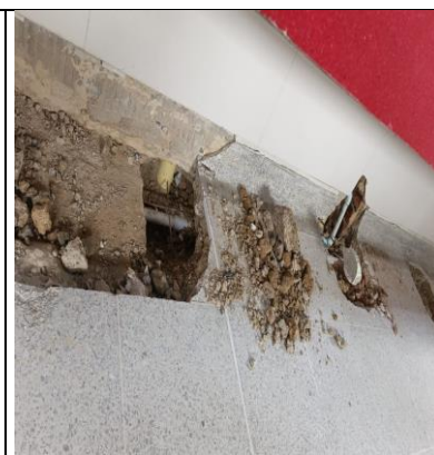
Baño hombres del tercer piso presencia de humedad bajo mesón
