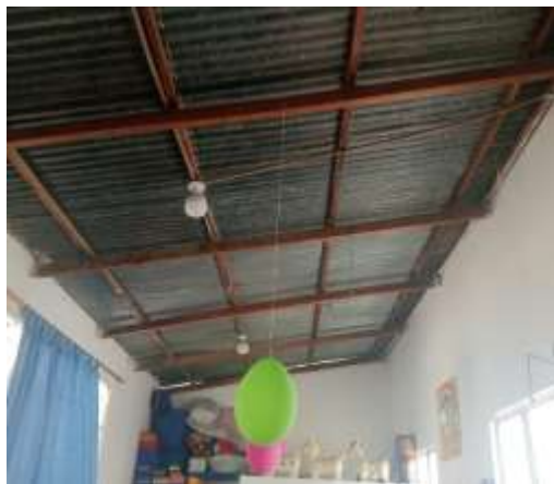
Estado inicial cubierta salon preescolar en lamina de zinc y correas en madera
