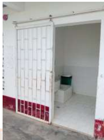
Puerta reja acceso unidad sanitario – Estado inicial
