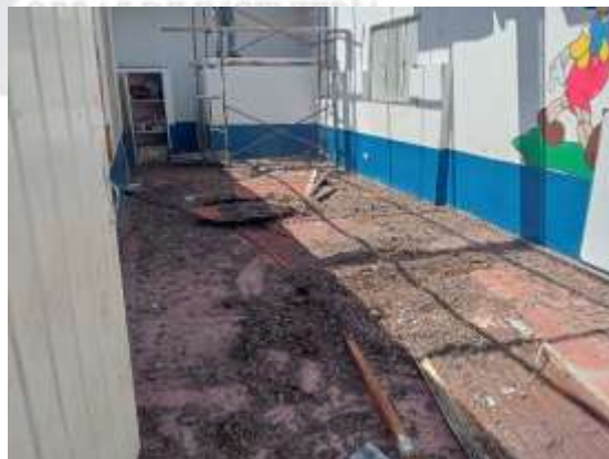
Residuos de cubierta – hojas y demas
