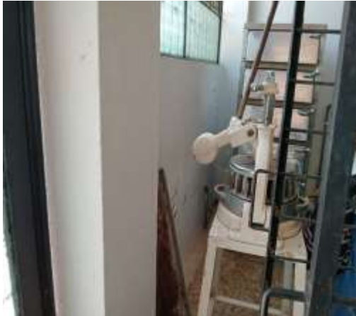
Estado inicial de los muros – afectaciones por humedad
