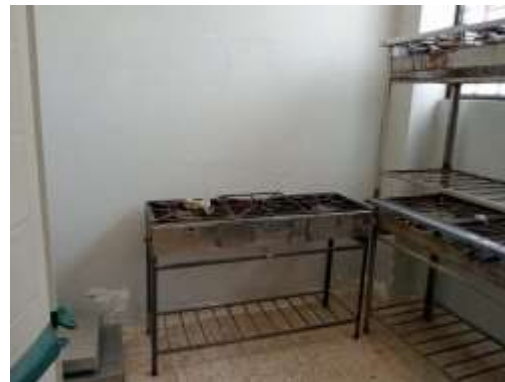
Estado inicial de los muros – afectaciones por humedad
