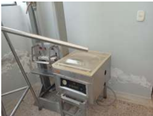
Estado inicial de los muros – afectaciones por humedad
