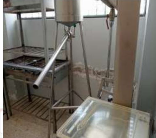
Estado inicial de los muros – afectaciones por humedad
