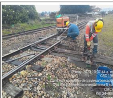
PK 34+000 MNTENIMIENTO CAMBIA VIAS
