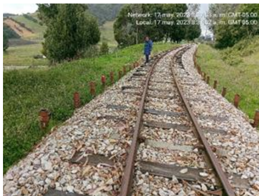
Foto 2. Identificación en sitio Boyacá PK 147+00 como punto crítico a ejecutar
