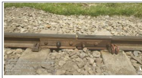
PK 239+900 NIVELACIÓN DE JUNTAS
