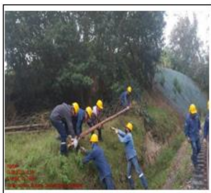
PK 79+200 RETIRO DE ARBOL EN LA VIA
