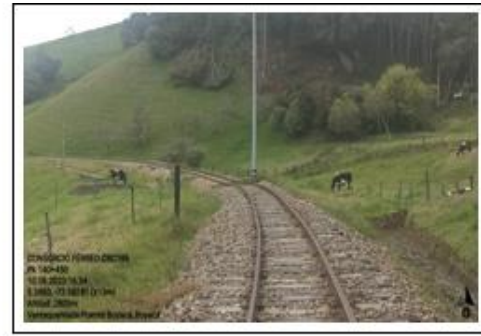
PK 140+450 HUNDIMIENTO DE BANCA
