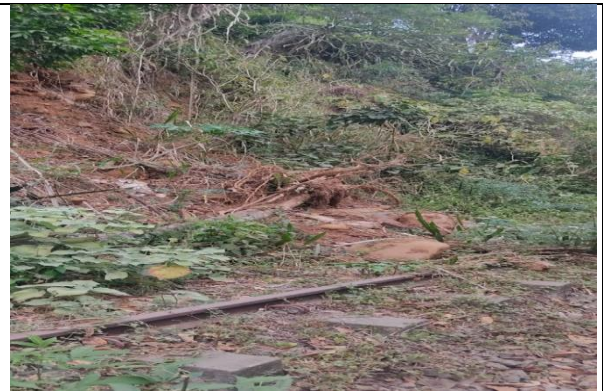
Derrumbe en el sector Cisneros y La Cumbre
