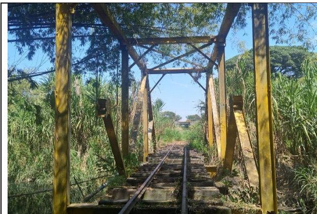
Puente sobre el río Amaime con elementos transversales robados.
