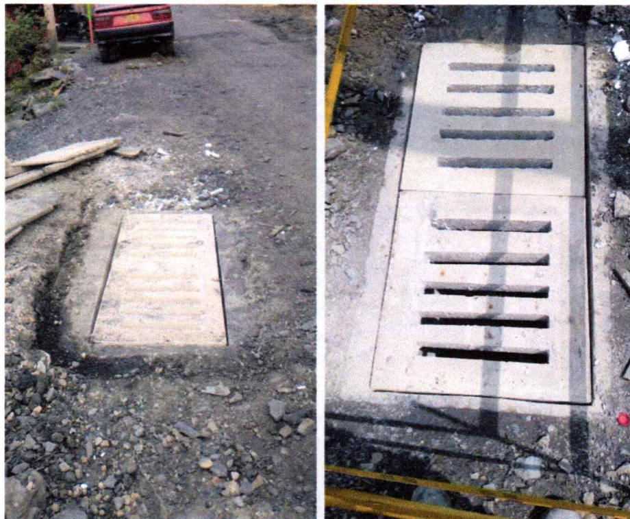
Foto 16. Sumideros laterales para recepción de aguas lluvias.
