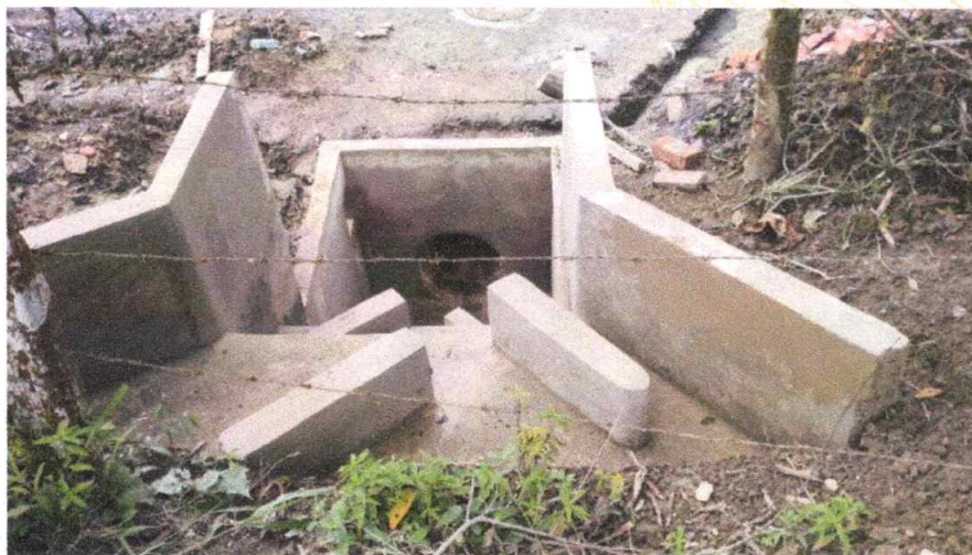
Foto 18. Caja de inspección.
