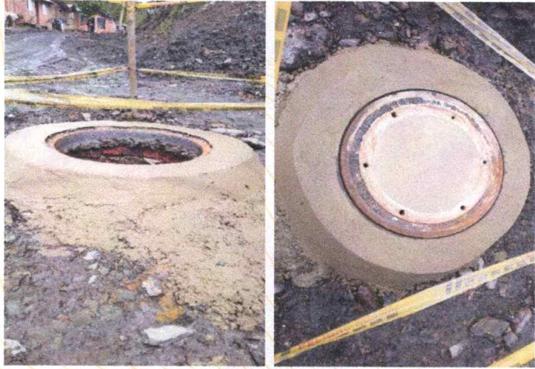
Foto 9. Pozos de inspección – recepción de aguas lluvias de los sumideros laterales.
