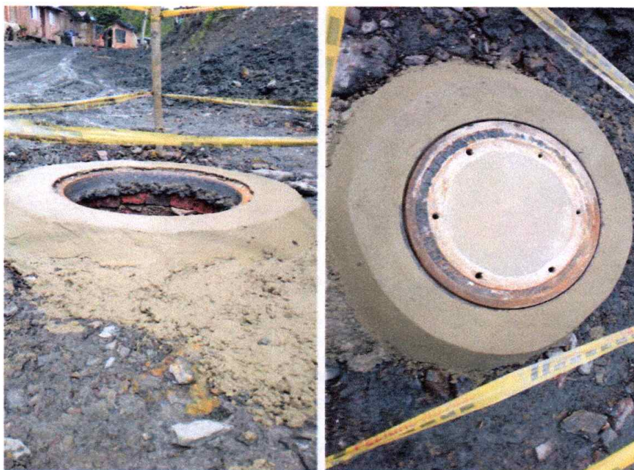
Foto 9. Pozos de inspección – recepción de aguas lluvias de los sumideros laterales.
