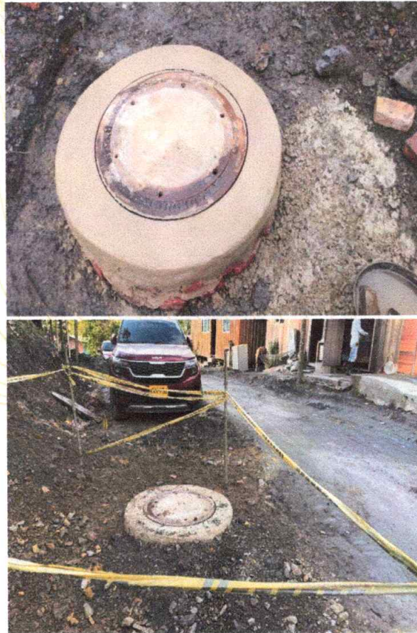
Foto 6. Aro y tapas para los pozos de inspección – recepción de aguas lluvias de los sumideros laterales.
