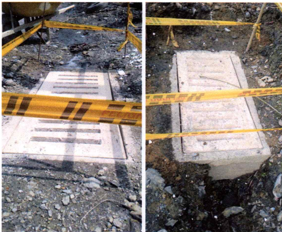
Foto 15. Sumideros laterales para recepción de aguas lluvias.
