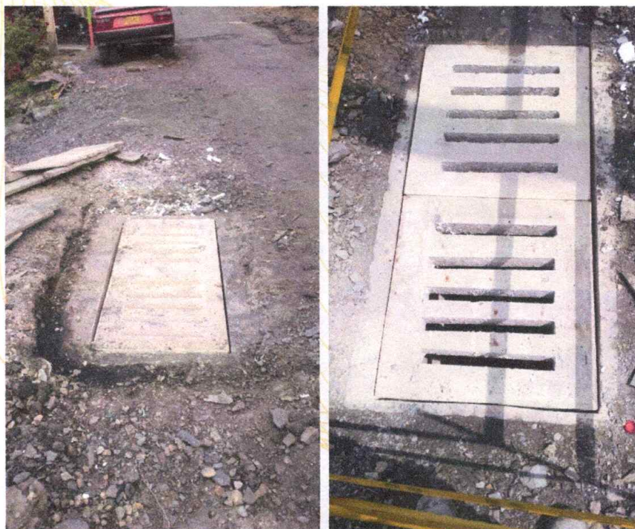
Foto 16. Sumideros laterales para recepción de aguas lluvias.
