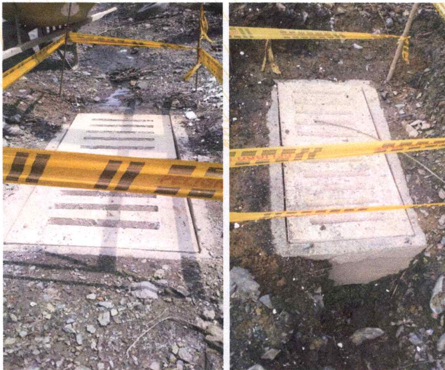
Foto 15. Sumideros laterales para recepción de aguas lluvias.
