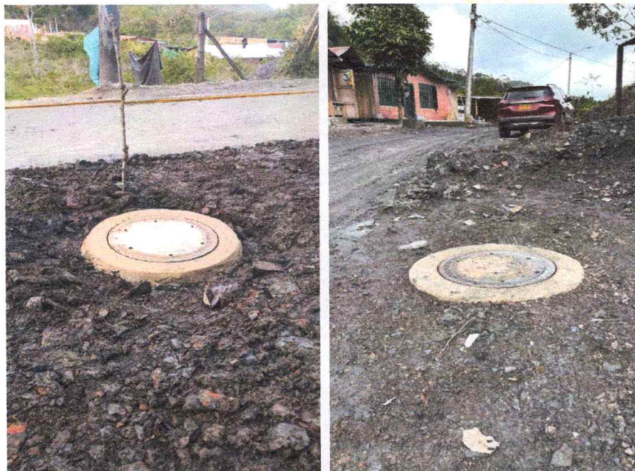
Foto 7. Aro y tapas para los pozos de inspección – recepción de aguas lluvias de los sumideros laterales.
