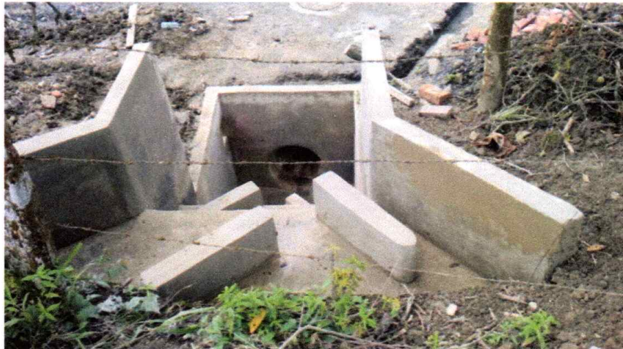
Foto 18. Caja de inspección.
