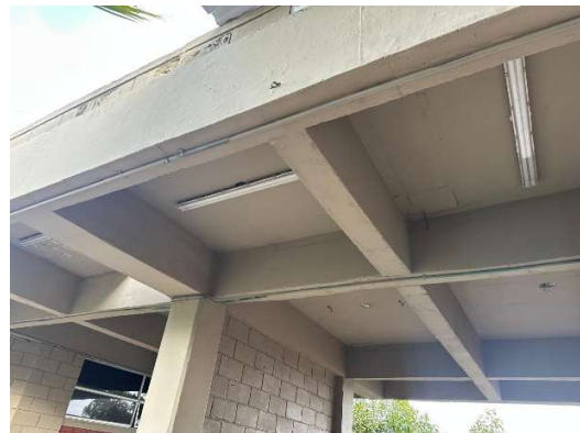
Imagen 57 Pintura en cielo raso
