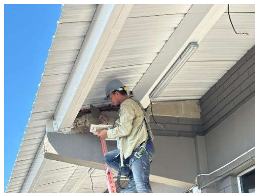
Imagen 9 Engolose de muro a cubierta
