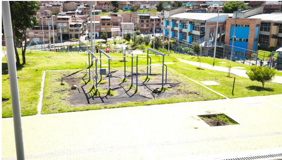
Foto # 4. Mantenimiento al área de multi fuerza se encuentra en mal estado.
