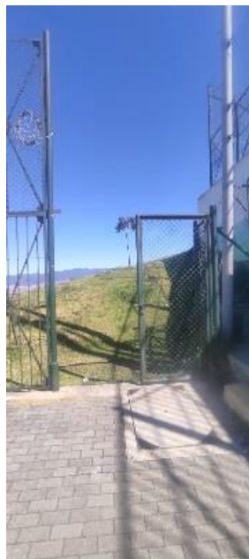
Foto # 8 Puerta de la cancha # 1 está deteriorada
