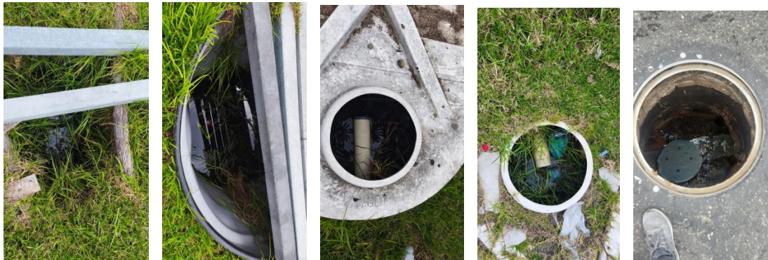
Foto # 17. Mantenimiento del pozo séptico recomendación de la secretaria de salud.
