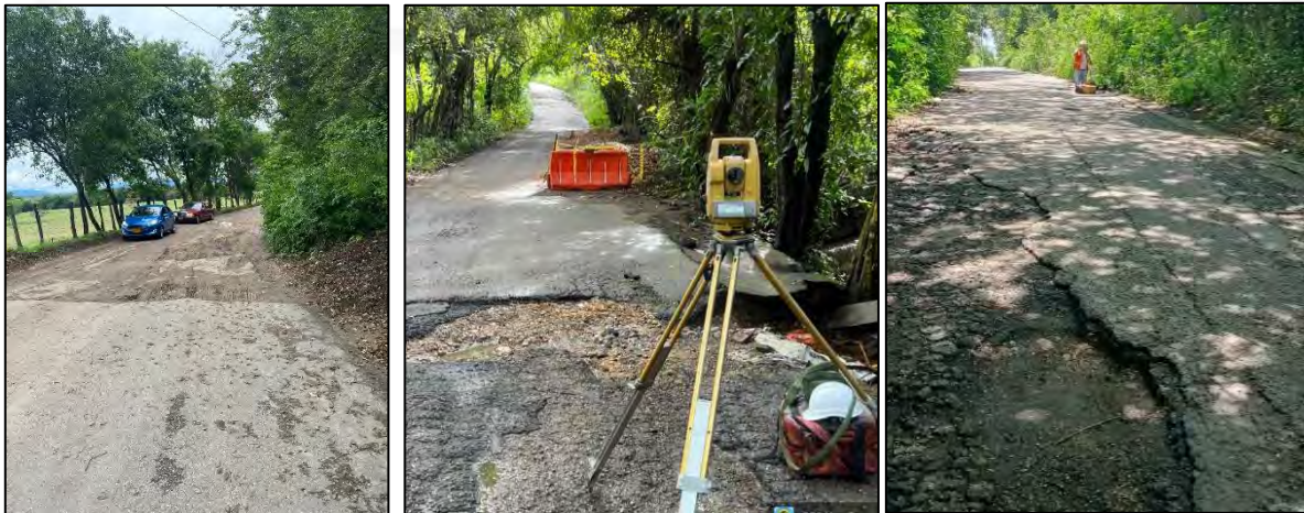
Ilustración 5. Estado actual de la vía
