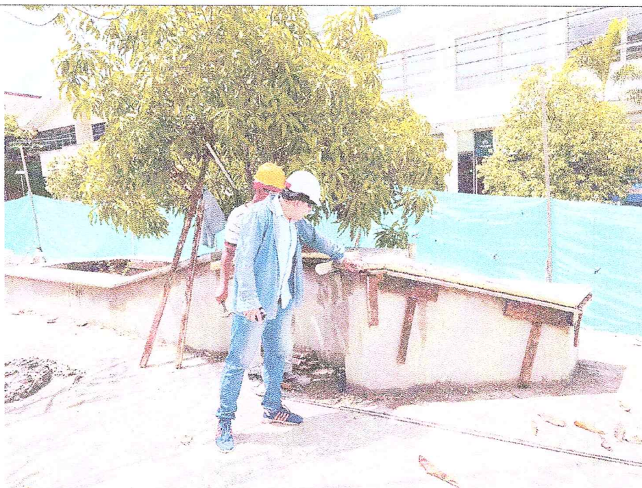
CHEQUEO DE ACABADOS EN BORDES DE JARDINERA Y MEDIDAS
