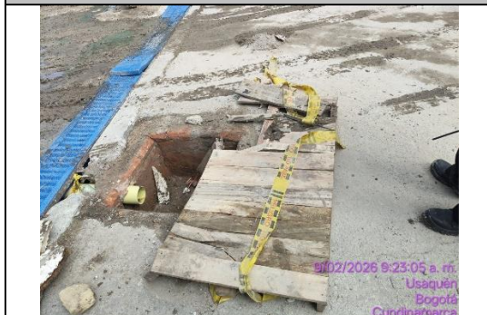
Imagen 51. Daño de tapa de caja de aguas negras externo de la obra
