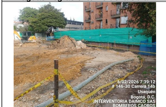
Imagen 53. Daño de señalización en sendero peatonal
