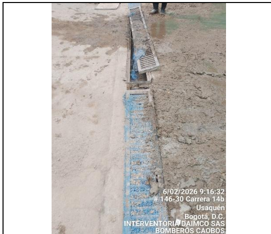
Imagen 49. Condición Insegura-Parrillas de la Entrada de la Obra dañados
