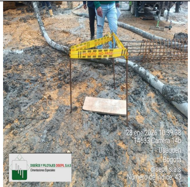
se señala el área de el pilote abierto con el fin de identificar el área de caída o tropiezo
