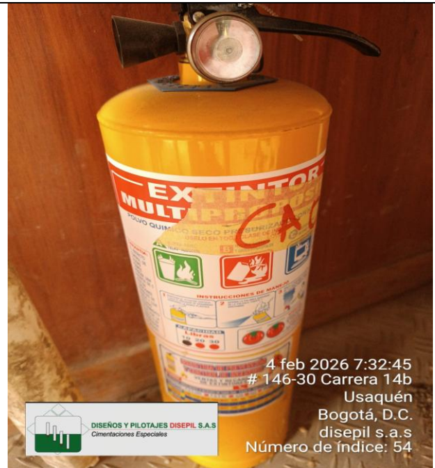
se inspecciona el extintor con el fin de poder verificar que este en buenas condiciones para su funcionamiento
