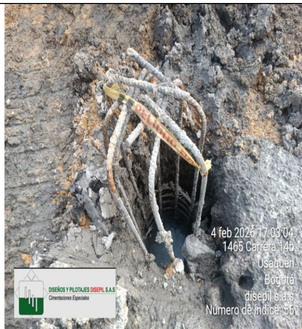
se demarcan el hacero del pilote con el fin de que se identifique el peligro de tropiezo
