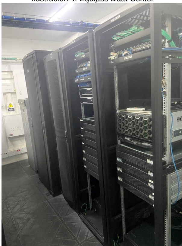
Ilustración 4: Equipos Data Center
