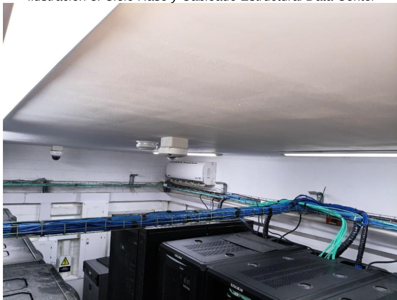
Ilustración 5: Cielo Raso y Cableado Estructural Data Center
