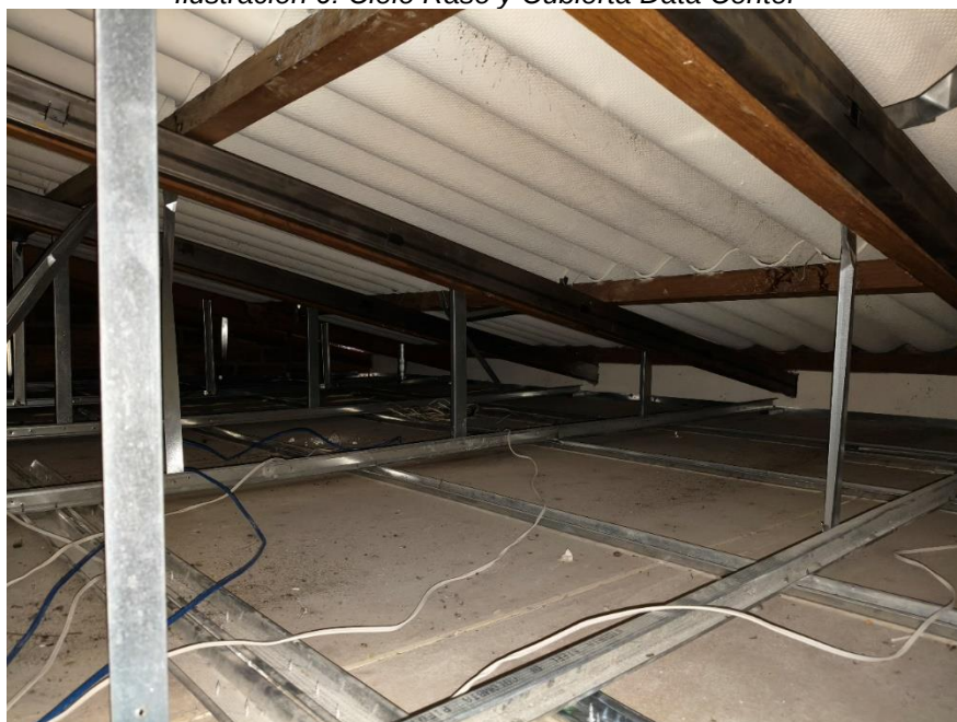
Ilustración 6: Cielo Raso y Cubierta Data Center
