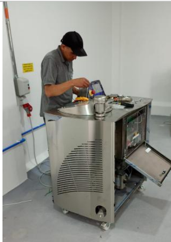
Imagen 4: Mantenimiento de equipos.
