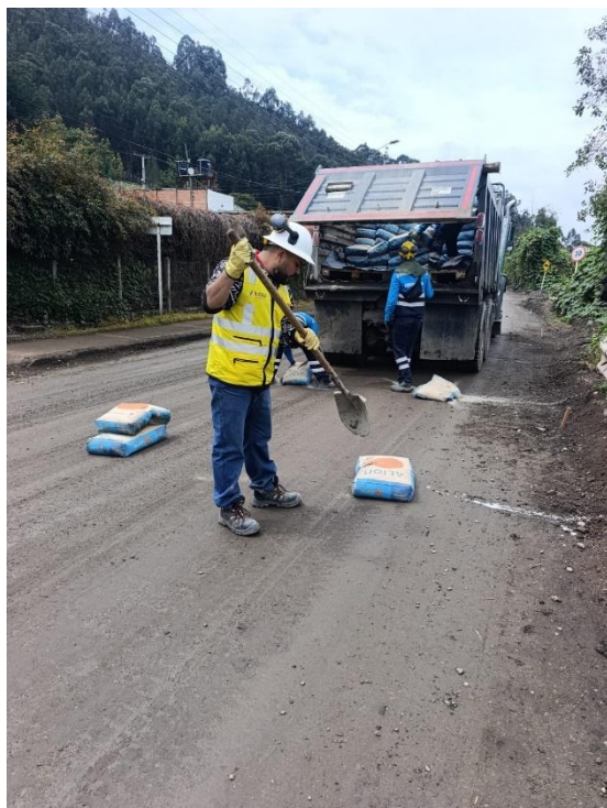
Ilustración 12, Distribución de Cemento.
