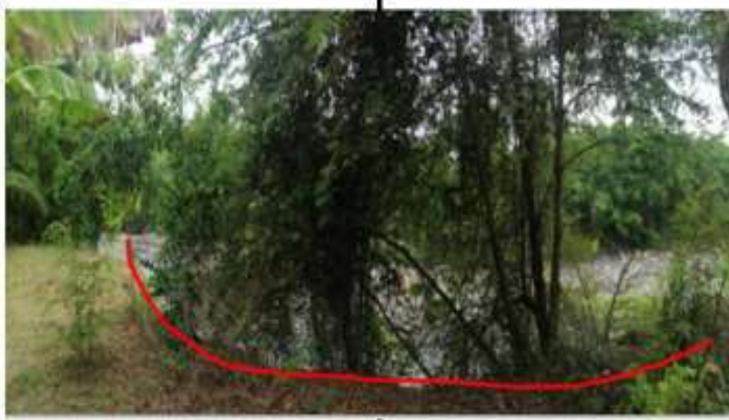
PUNTO DE INTERVENCION SOCAVACIÓN MARGEN DERECHA
