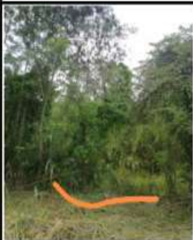
PUNTO DE INTERVENCION - VISTA SUPERIOR DE LA SOCAVACIÓN
