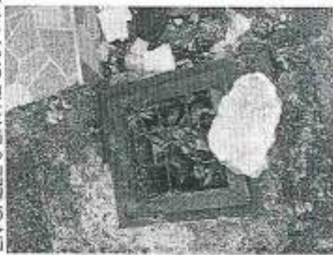
CAJA DE INSPECCIÓN ELÉCTRICA EN CALLE 8 ENTRE CRA 4 Y 5
