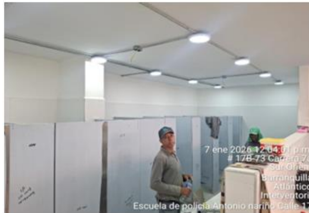
Ilustración 22. Instalaciones eléctricas y enchape de baños
