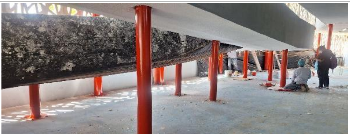
MANTENIMIENTO DE COLUMNAS METALICAS EN MAL ESTADO
