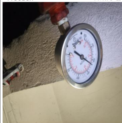
Lectora estación de control uni 1 s2(180psi)
