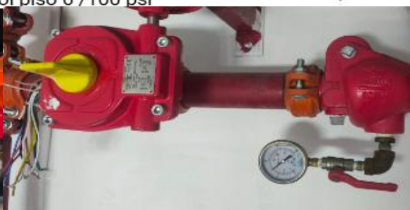
Estación de control piso 9 y 10 / 105 psi
