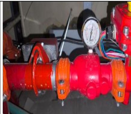
Estación de control piso 2 / 115 psi
