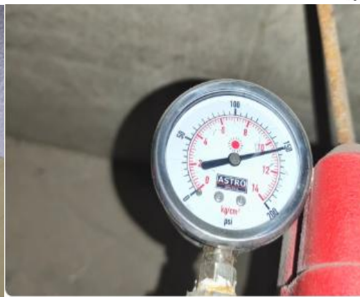
Lectora estación de control uni 1 s3 (150psi)
