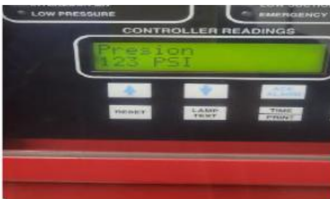
Prueba de funcionamiento bomba eléctrica san agustín
