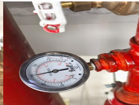
Lectora estación de control uni 1 s1 (150psi)
