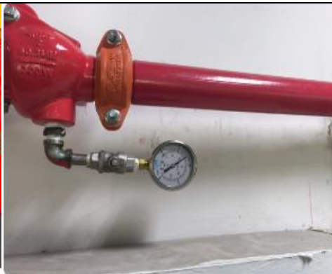
Estación de control piso 4 / 110 psi ,
