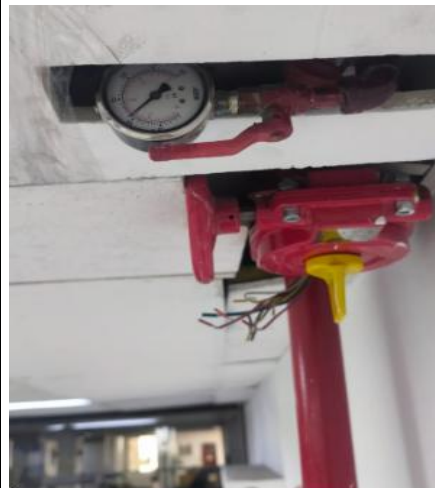
Estación de control piso 5 / 110 psi
