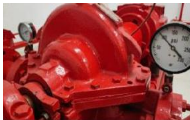
Rendimiento bomba eléctrica 100 psi
