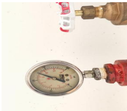
Lectora estación de control uni 1 p2 (130psi)
