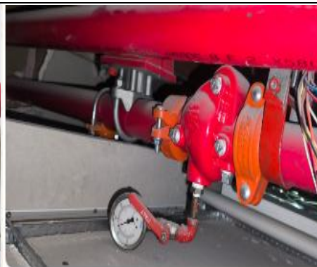
Estación de control piso 3 / 120 psi
