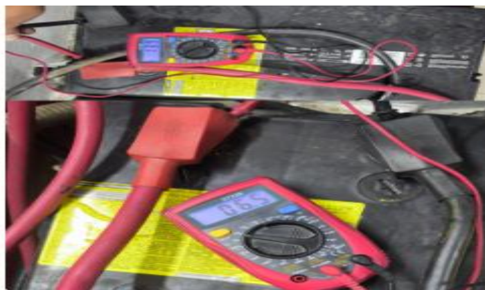
Voltajes baterías extrema 8D RCI san Agustín bomba diesel (requiere cambio )
