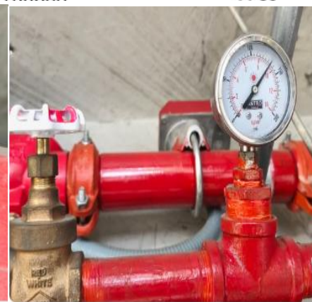
Lectora estación de control uni3 p1 (135psi)
