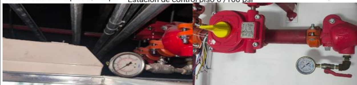
Estación de control piso 8 / 100 psi
