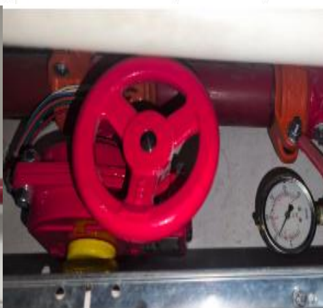
Estación de control piso 7 / 95 psi
