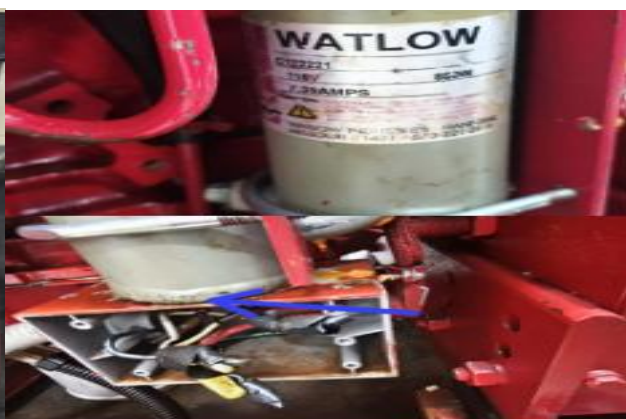
Precalentador de calor requiere cambio daño parte interior del mismo
