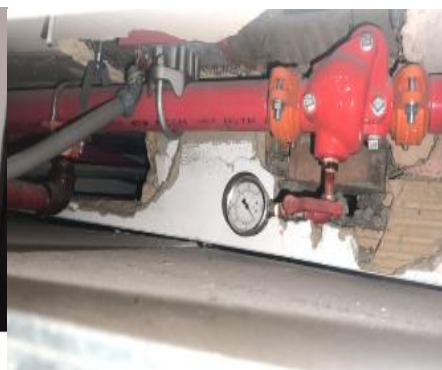
Lectura estaciones de control san Agustín Sótano / 0 psi despresurizado por obras
