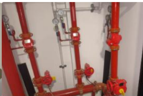
Sistema RCI reacer gabinetes , aspersores costado norte y aspersores costado sur se encuentra presurizado a 110 psi y válvulas mariposa habilitadas
