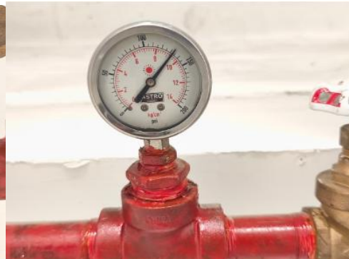
Lectora estación de control uni 1 p1 (133psi)
