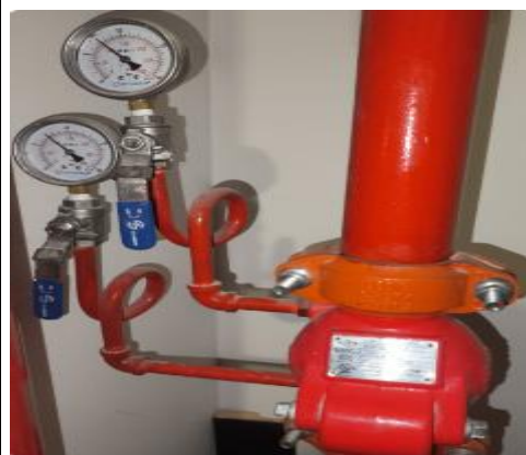
Columna de 2" red de aspersores costado sur en encuentra en 105 psi
