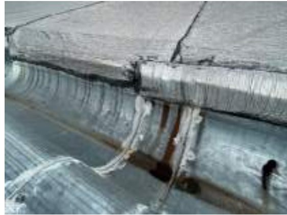
Ilustración 31 Fotografía detalle de canal y manto asfáltico de cubierta cuerpo central, 2025. Fuente: Consorcio Interhospital PAC
