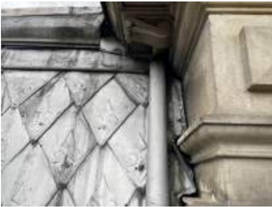
Ilustración 29 Fotografía detalle de tejas y bajante en mansarda en fachada principal, 2025. Fuente: Consorcio Interhospital PAC
