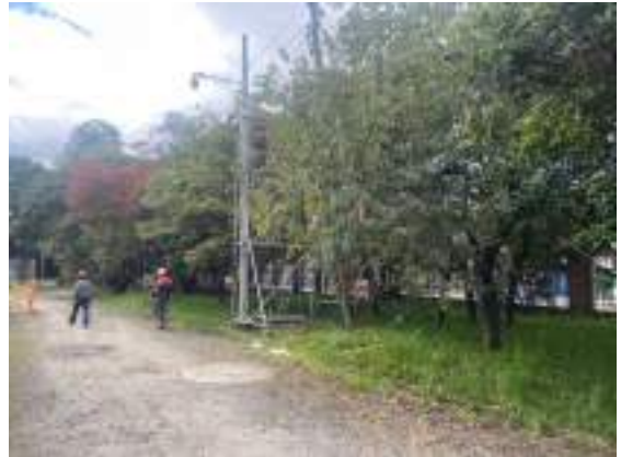
Ilustración 9 Fotografía conexión provisional de energía, 2025. Fuente: Consorcio Interhospital PAC.
