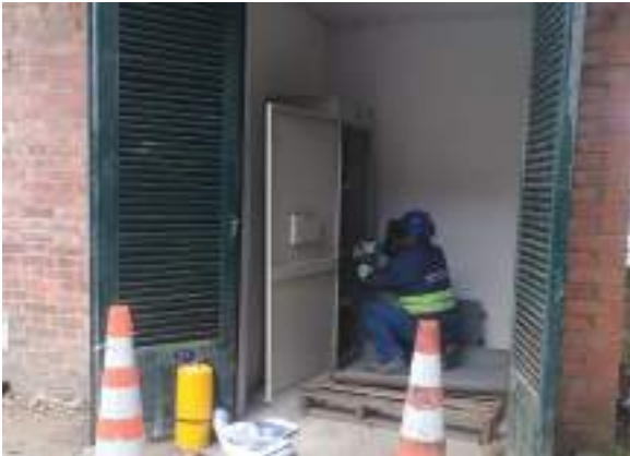
Ilustración 20 Fotografía conexión provisional de energía, 2025. Fuente: Consorcio Interhospital PAC
