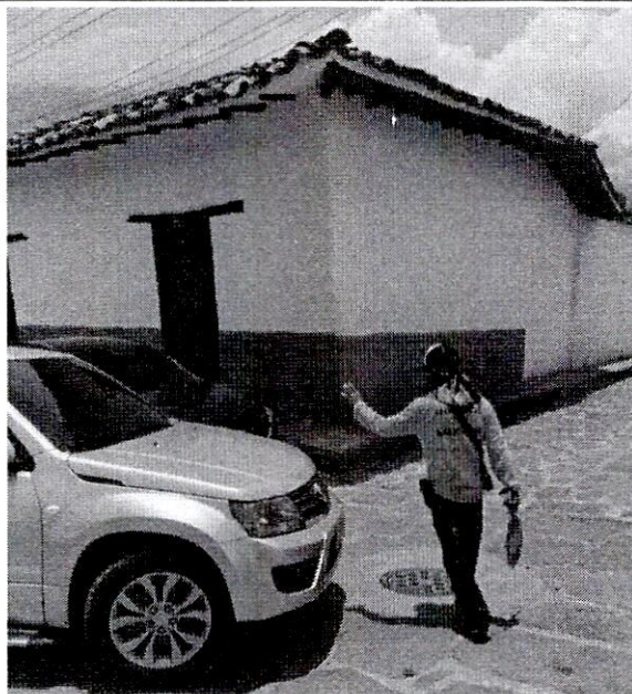
Punto 14. Regulador ubicado en el ingreso del centro poblado Guane.
