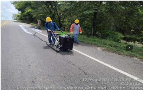
Tramo El viajano- San Marcos Sello de firuras entre el PR0 +000 y PR2+000
