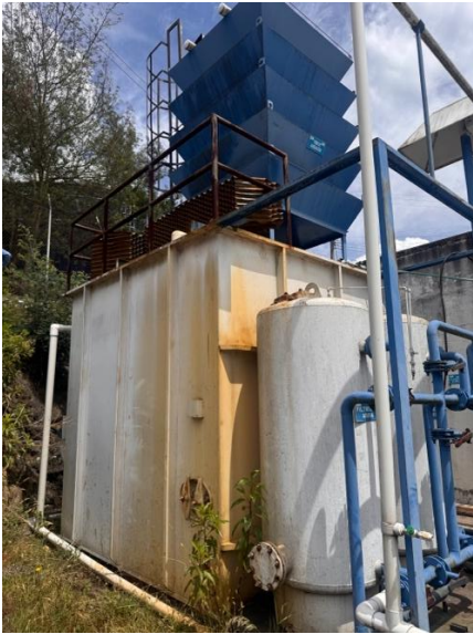
FOTOGRAFIA : Modulo de sedimentación con corrosión
