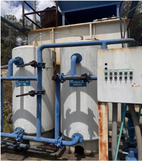
FOTOGRAFIA : Redes de conexión hidráulica.
