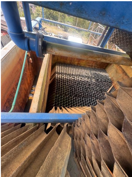
FOTOGRAFIA : para el proceso de sedimentación se utilizan módulos de sedimentación tipo colmena
