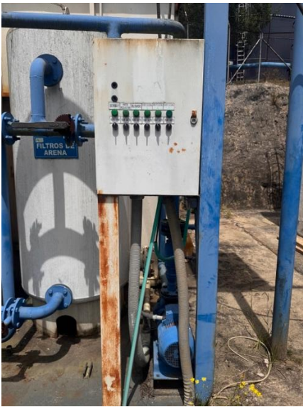
FOTOGRAFIA : Tablero de control de bomba de impulsión de filtros
