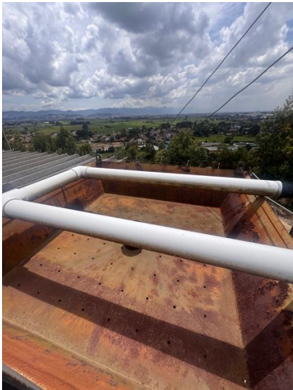
FOTOGRAFIA : Flauta de entrada de agua potable en PVC
