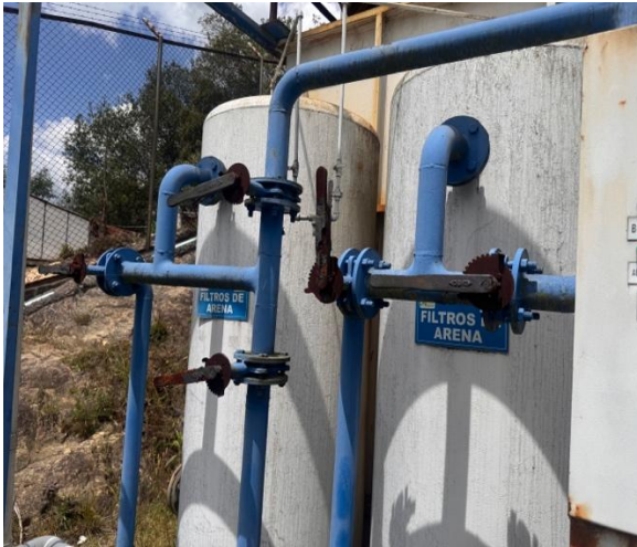
FOTOGRAFIA : Válvulas tipo mariposa
