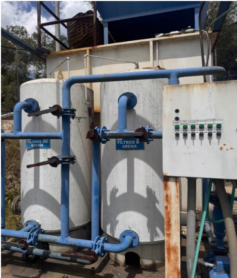
FOTOGRAFIA : Sistema de filtro lento en arena.
