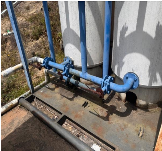
FOTOGRAFIA : Base de planta oxidada y por reparar
