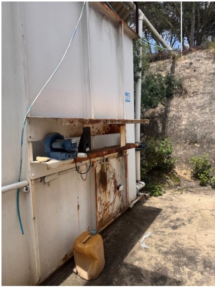
FOTOGRAFIA : Bomba dosificadora de productos quimicos
