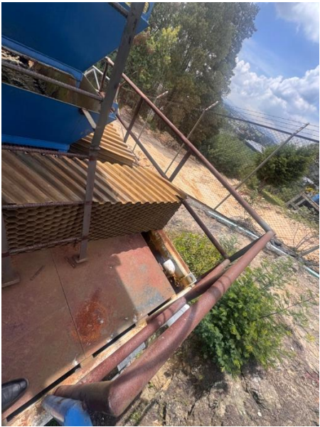
FOTOGRAFIA : Lamina y barandas oxidadas
