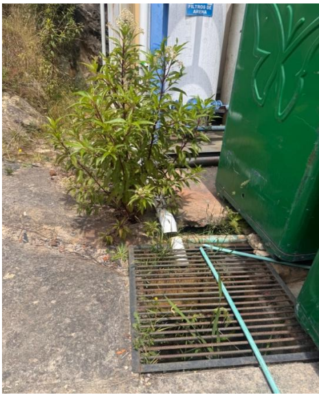
FOTOGRAFIA : Cárcamo de evacuación de aguas de retro lavado de filtros.
