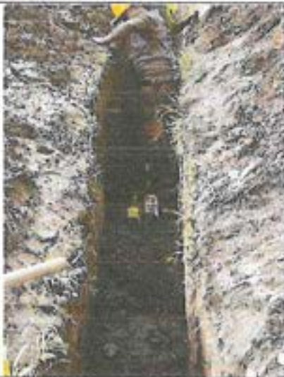
Fotografía 15. Presencia de nivel freático en zonas de excavaciones para el sistema sanitario del proyecto.
