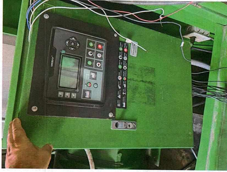
D N° 3. INSTALACION CABLES DE CONTROL
