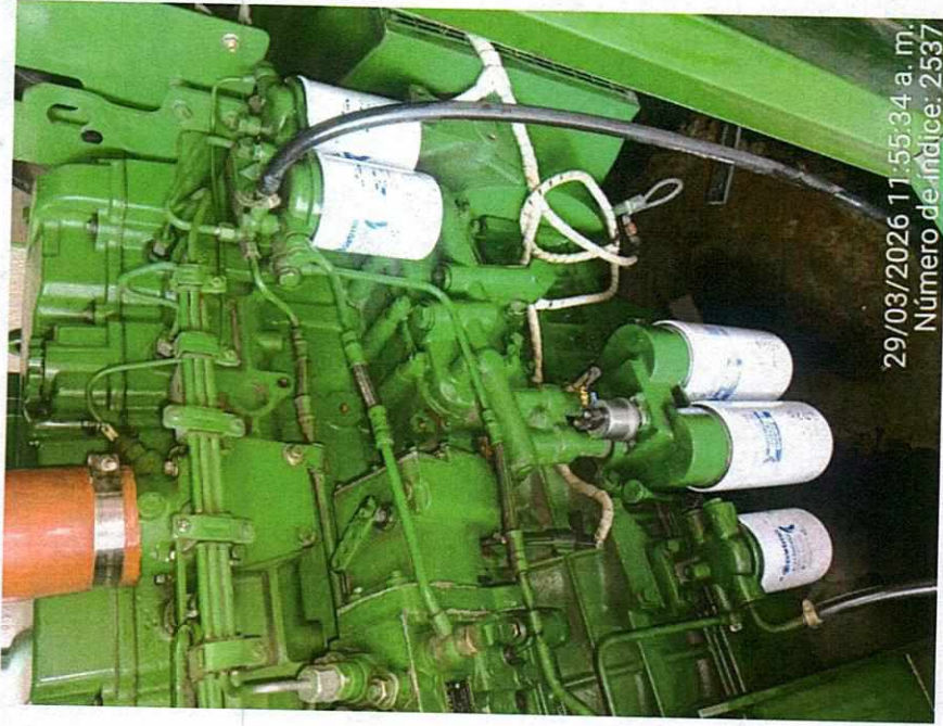
D N° 8 CAMBIO TOTAL DE FILTROS
