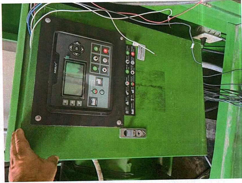
D N° 3. INSTALACION CABLES DE CONTROL
