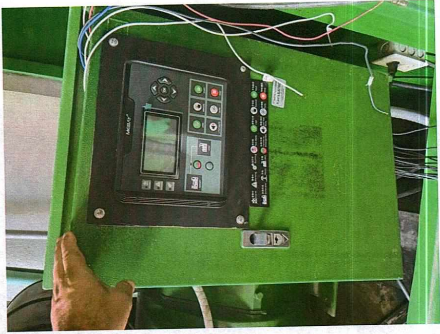
D N° 3. INSTALACION CABLES DE CONTROL
