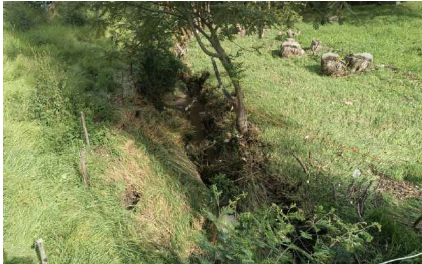
Fotografía 8. Estado actual de la quebrada Barbanica. Fuente propia.
