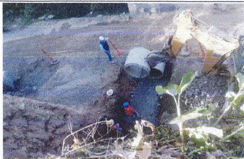
Se baja tubería costado izquierdo alcantarilla PR4+601
