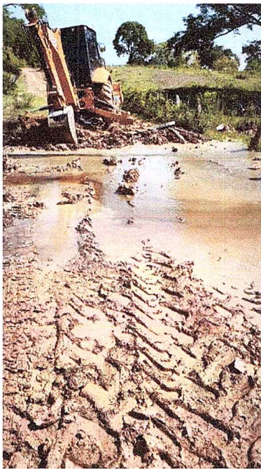
Ilustración 14. Estancamientos de agua por lluvias.
