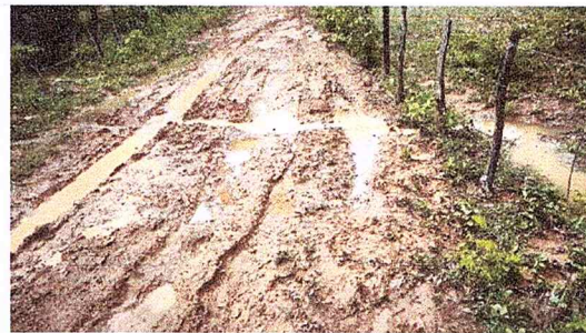
Ilustración 13. Afectaciones por lluvias.
