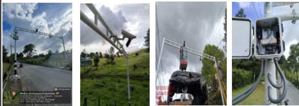
Suministro e instalación sistema LPR para dos sentidos viales, incluye sistema de comunicaciones y licenciamiento anual . UBICACIÓN: LEJOS DEL NIDO
