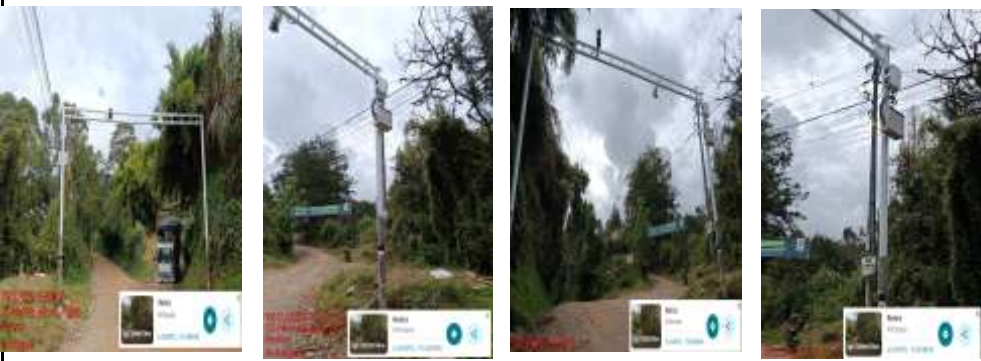
Suministro e instalación sistema LPR para dos sentidos viales, incluye sistema de comunicaciones y licenciamiento anual . UBICACIÓN: ALTO DE LA GUIJA
