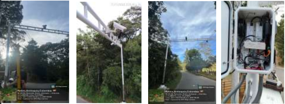
Suministro e instalación sistema LPR para dos sentidos viales, incluye sistema de comunicaciones y licenciamiento anual . UBICACIÓN: PISTA DE MOTOCROS
