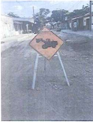
Señales móviles maquinaria en la vía
