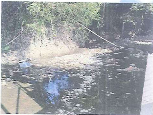
Registro fotográfico 32: Caño Maizaro a la altura del cabezal de descarga del alcantarillado pluvial.
