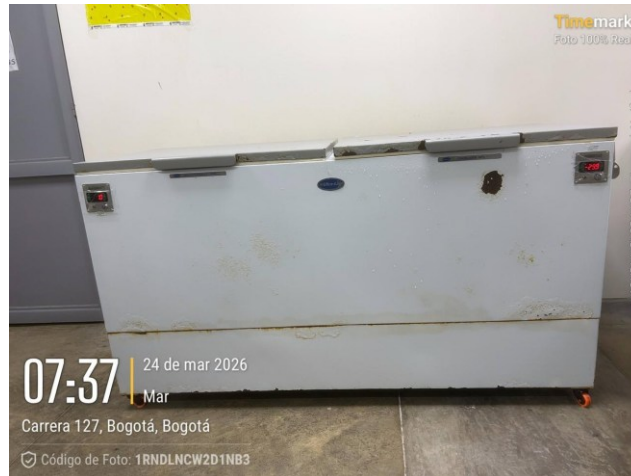
Foto 55. Almacenamiento de residuos peligrosos con características infecciosas que requieren refrigeración (animales muertos).
