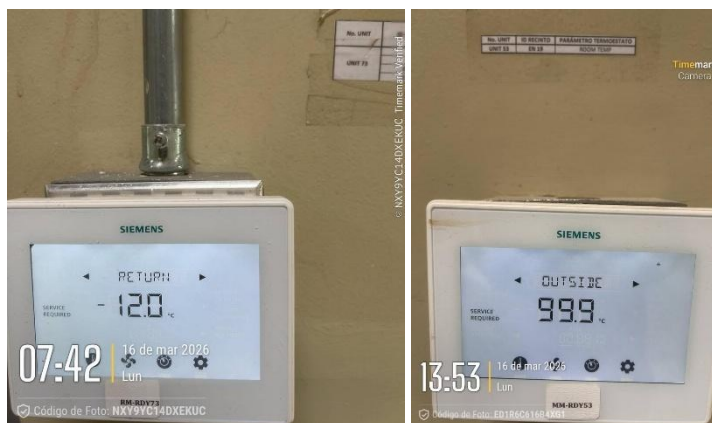
Foto 56-57. Fallas en pantallas de registro de temperatura
