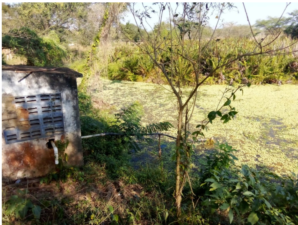
Foto 5 Estado del sistema de Captación Garrapata
