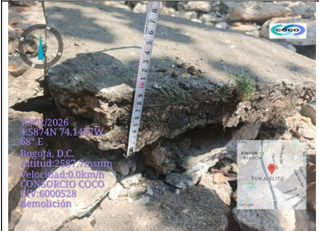
Foto 7. Evidencia que la demolición y excavación manual fue superficial.
