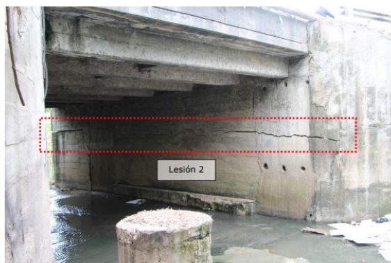
Fotografía 14 – identificación daño 2 Fisura Longitudinal por flexión (FIF) 2
