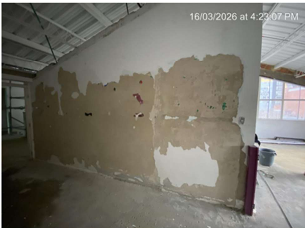
21. PICADA DE PINTURA EN MUROS INTERNOS
