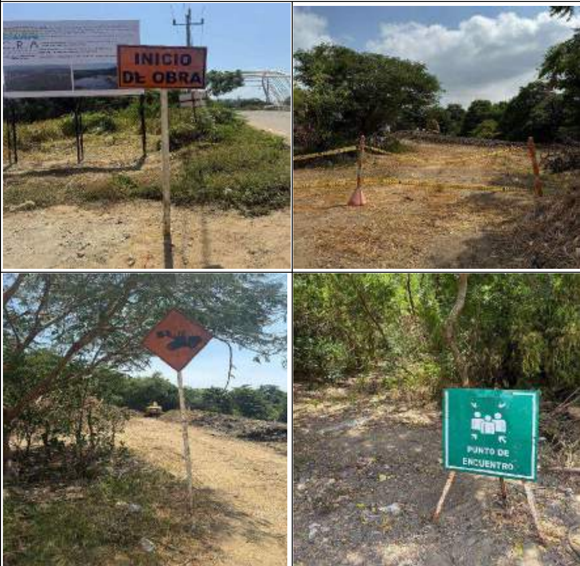
Imágenes 15, 16, 17 y 18 Evidencias de señalización en la obra.
