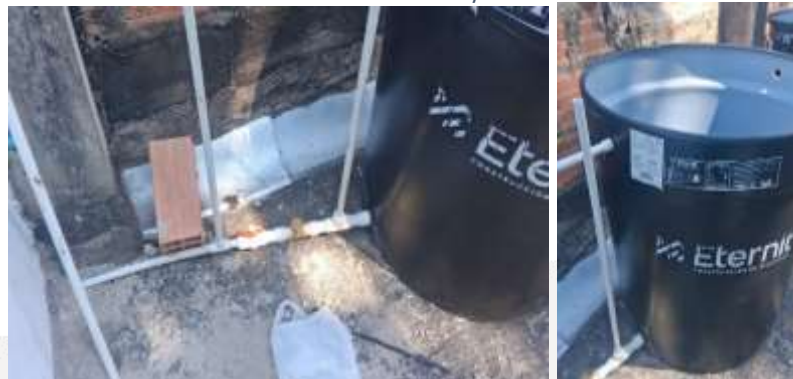
Ilustración 18. Conexión tanque elevado PVC
