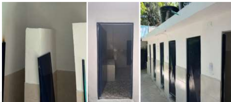
Ilustración 16. Puerta en lámina cal 18 inc. Anticorrosivo
