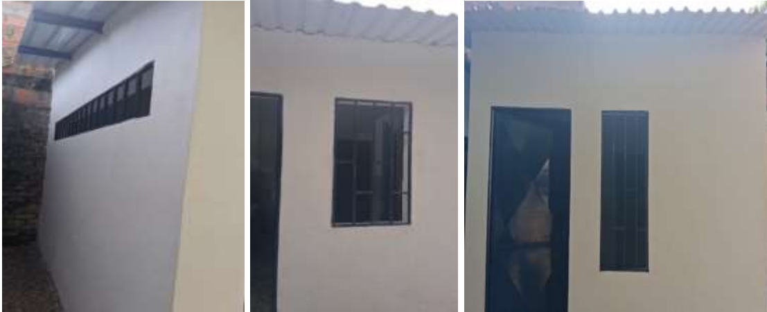
Ilustración 38 Vinilo sobre pañete
